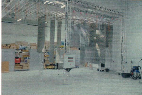
Getrocknet werden die Jalousien in einer dafür konstruierten Trockenanlage, in der die Jalousien auch gewartet und repariert werden können.
