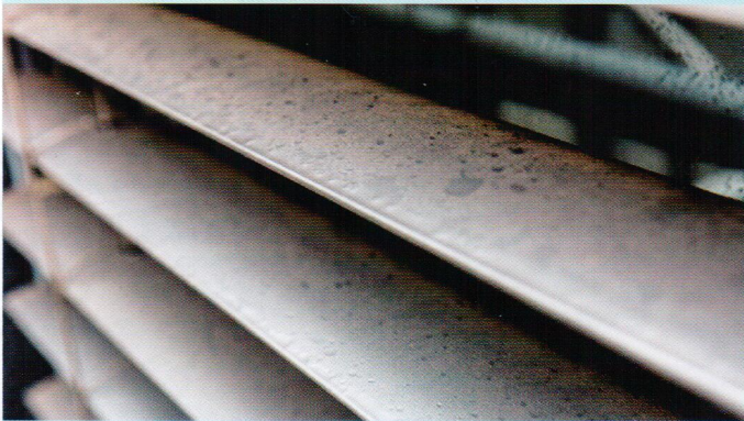
Die Außenjalousien am Omega-Haus wurden seit dem Einbau im Jahr 1995 nicht mehr gereinigt, waren aber technisch in gutem Zustand.
