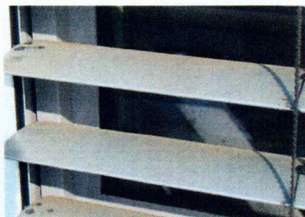
In sieben Jahren hat sich eine dicke Schmutzschicht angelagert...
