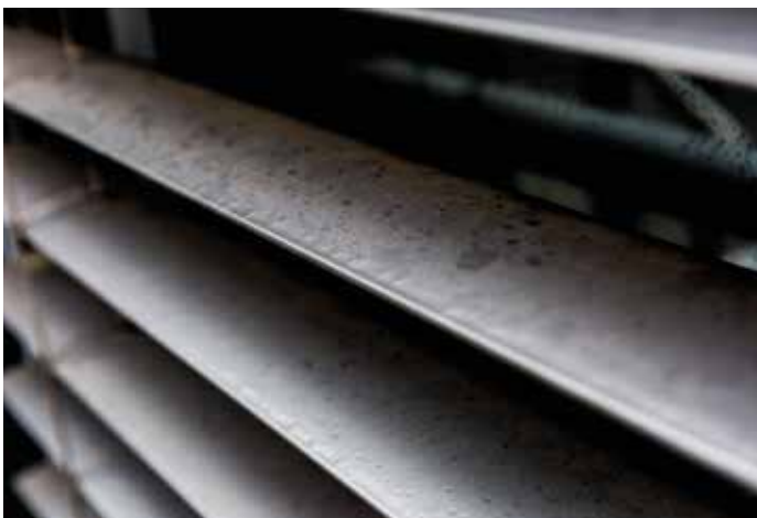
Hier sind die Lamellen vor der Reinigung zu sehen.
